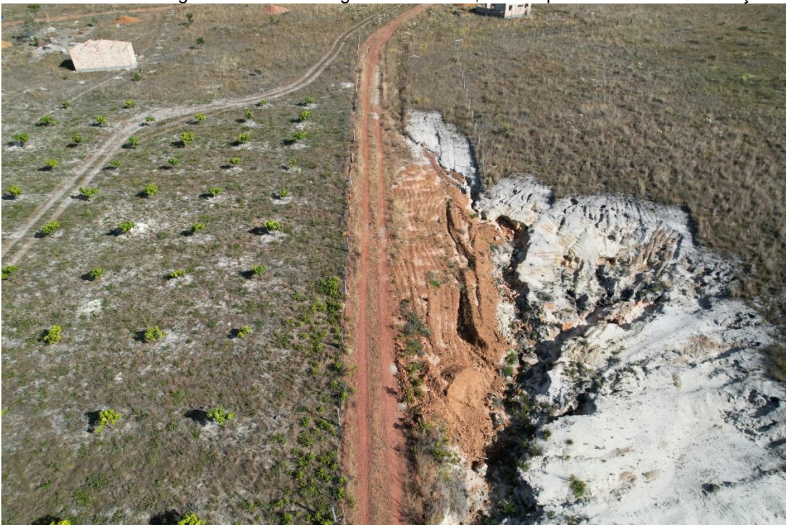
Figura 03: Vista da região mais crítica, onde é possível observar as voçorocas.
